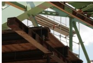
Auch beim Schwebebahnumbau haben die Bohrer der Gebr. Daprich so manche Nachtschicht gerettet.
